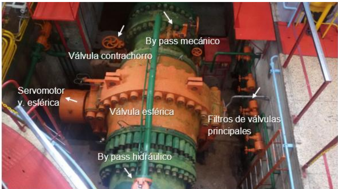
Figura 1 - Foso de válvulas de una unidad generadora tipo Pelton y accesorios principales. Fuente: elaboración propia
