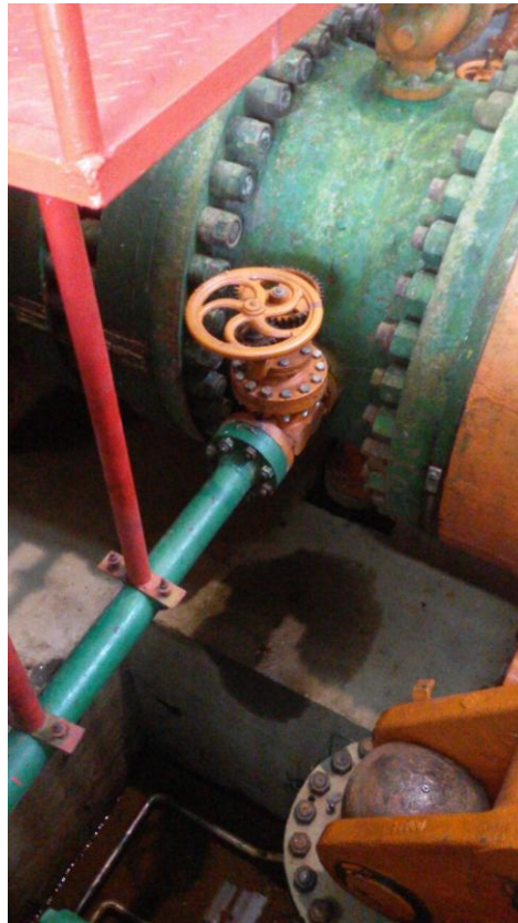
Figura 2 - Válvula reguladora de 4" del sistema del contrachorro. Fuente: elaboración propia
