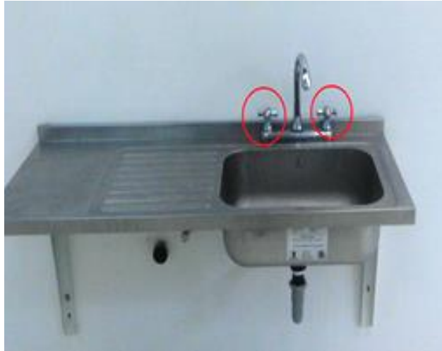
Figura 40. Focos de contaminación
