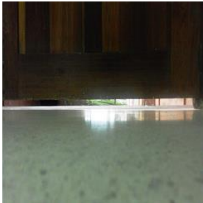
Figura 39. Focos de contaminación
